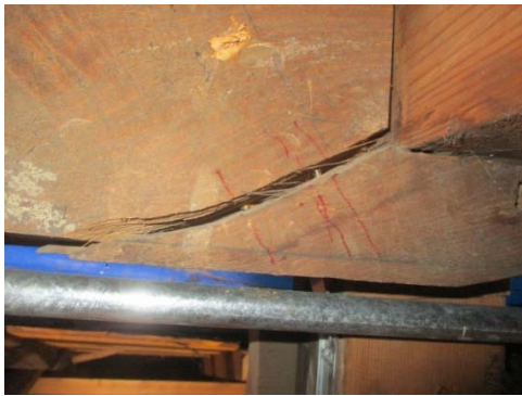
写真 3-1-68 胴差下端の割れ
