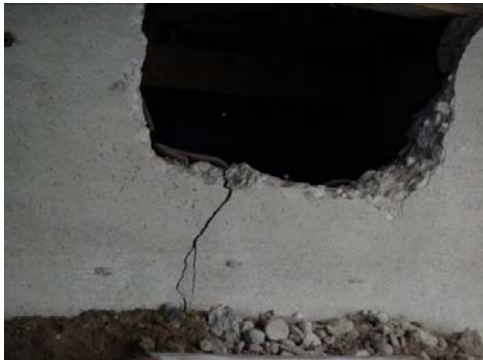
写真 3-1-60 人通口のクラック
