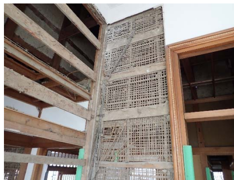
写真 3-1-74 壁内の配線状況
