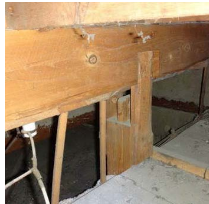
写真 3-1-47 隙間が空いた柱-梁
