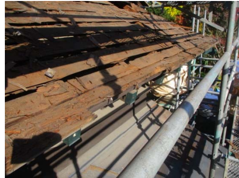
写真 3-1-43 広小舞の腐朽
