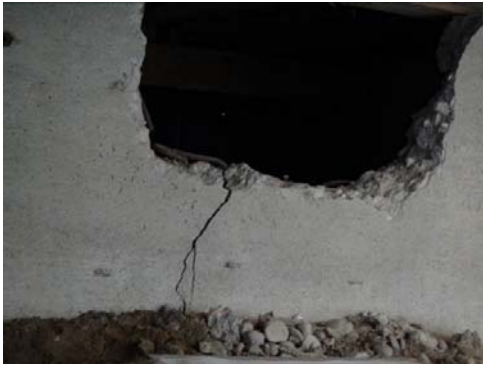
写真 3-1-3 人通口から生じたクラック
