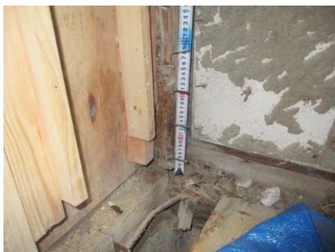
写真 3-1-64 洋室（1）北東隅柱の腐朽
