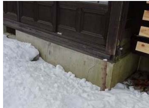
写真 3-1-61 予備室東側のクラック
