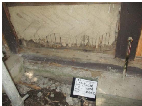
写真 3-1-62 玄関西側の土台腐朽
