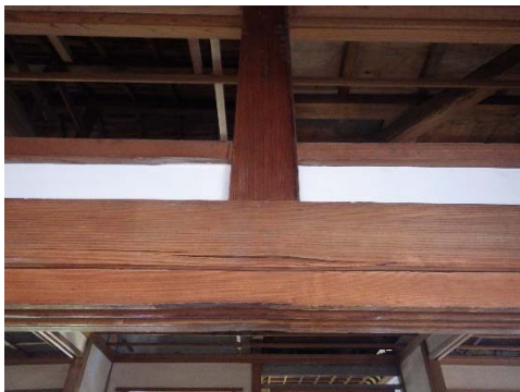
写真 3-1-66 たわみ対策として鴨居下に補強した跡
