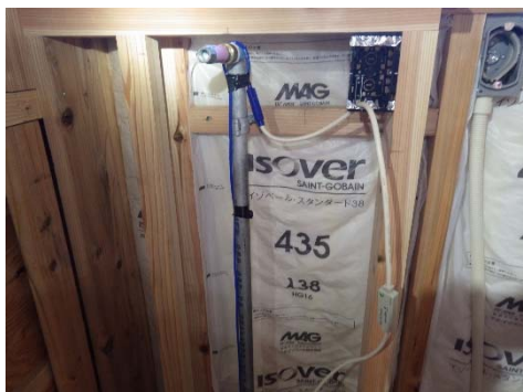
写真 2-4-73 凍結防止ヒーター
