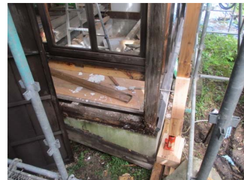
写真 3-1-63 予備室南側の土台腐朽
