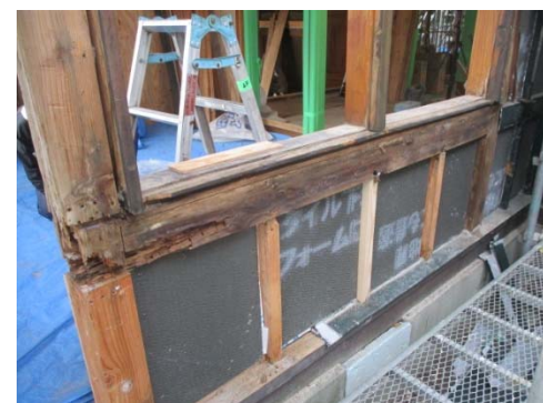
写真 3-1-65 洋室（1）北東柱の腐朽
