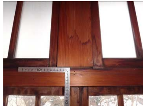
写真 3-1-71 束と鴨居の隙間
