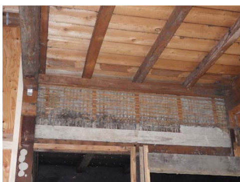
写真 3-1-22 1階天井裏の木舞
