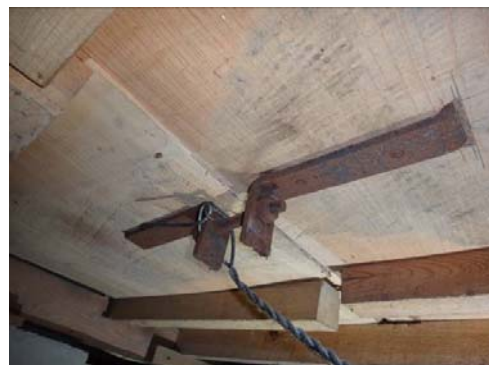
写真 3-1-8 縁側床下の根太と金物
