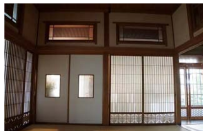
玄関ホールに面する柱の傾斜
