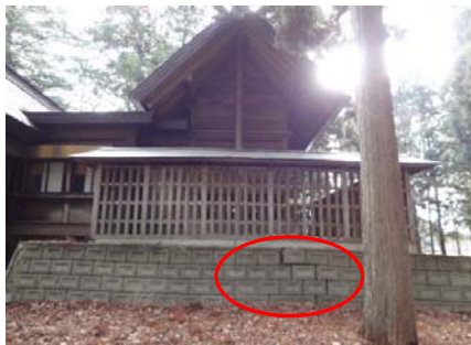
本殿盛土基礎ブロックのクラック、傾斜(着手前)
