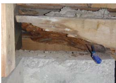
土台欠損部の腐朽の跡
