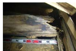
親梁の腐食状況(横から)
