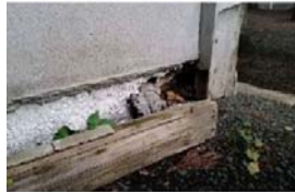
土台外部(腐食状況)
