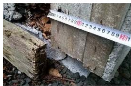
柱外部(腐食状況)
