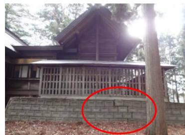
盛土基礎ブロックのクラック
