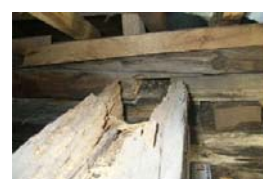
親梁の腐食状況(上から)
