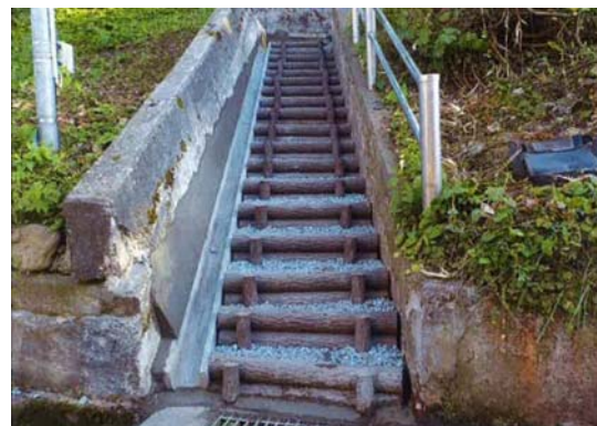
公園北側入口にある階段の補修(完了後) 階段の勾配を緩やかにするとともに、 景観型擬木丸太を使用
