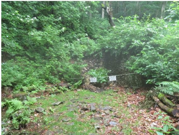
2016.7.7に一部崩落した7号倉庫石積壁 (2016.7.14撮影)
