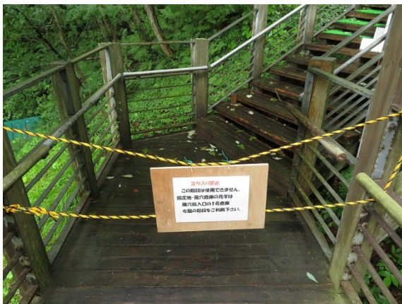
3階渡り廊下～屋外階段を閉鎖 (2016.7.12撮影)
