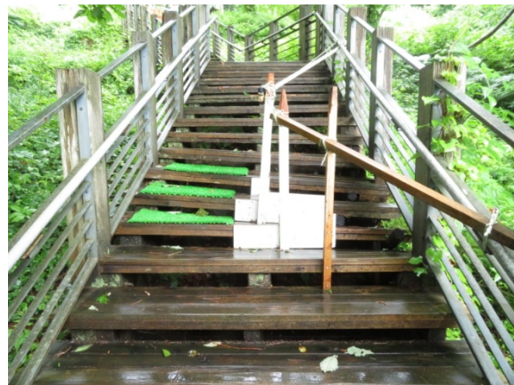
3階渡り廊下～屋外階段を閉鎖 (2016.7.12撮影)
