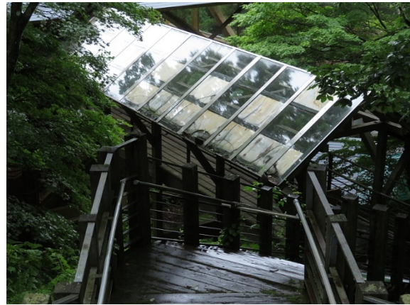
3階渡り廊下～屋外階段を閉鎖 (2016.7.12撮影)
